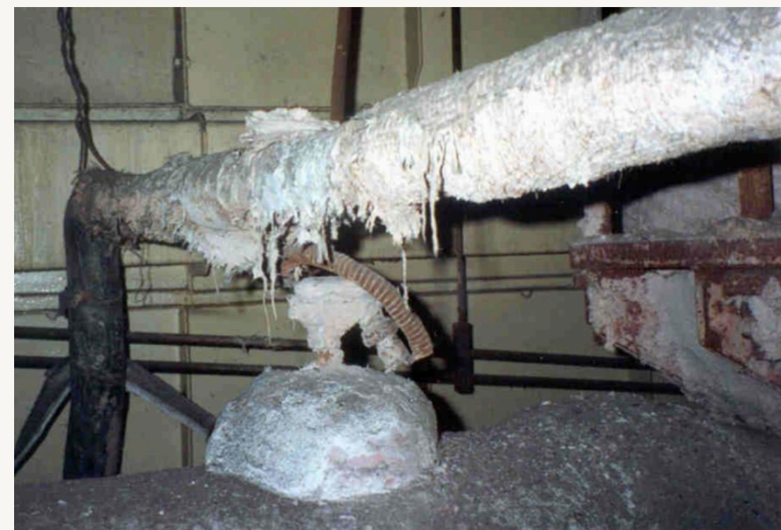
Calorifugat (tub caldera)
